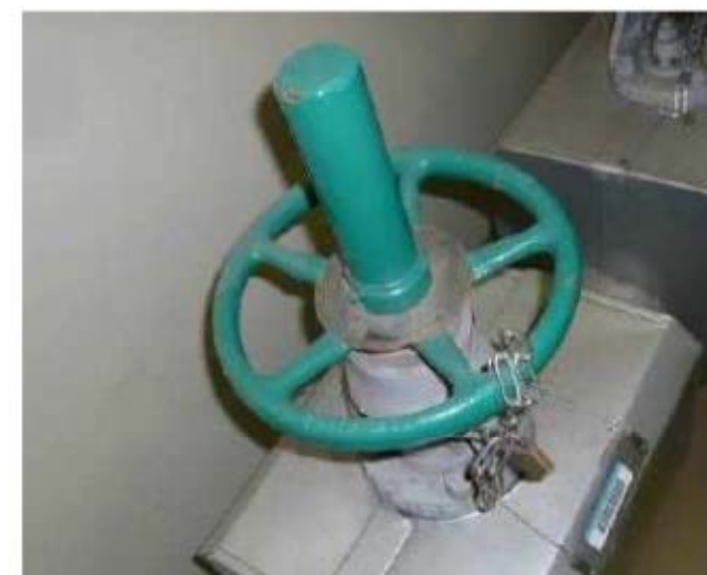
図2 弁施錠状態の例
