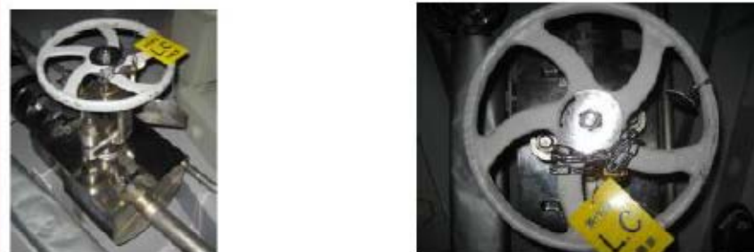
図2 弁施錠状態の例の写真
