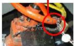
原子炉圧力容器ドレンライン 【CUW RPV 第一ドレン弁 (G31-F503X)】
