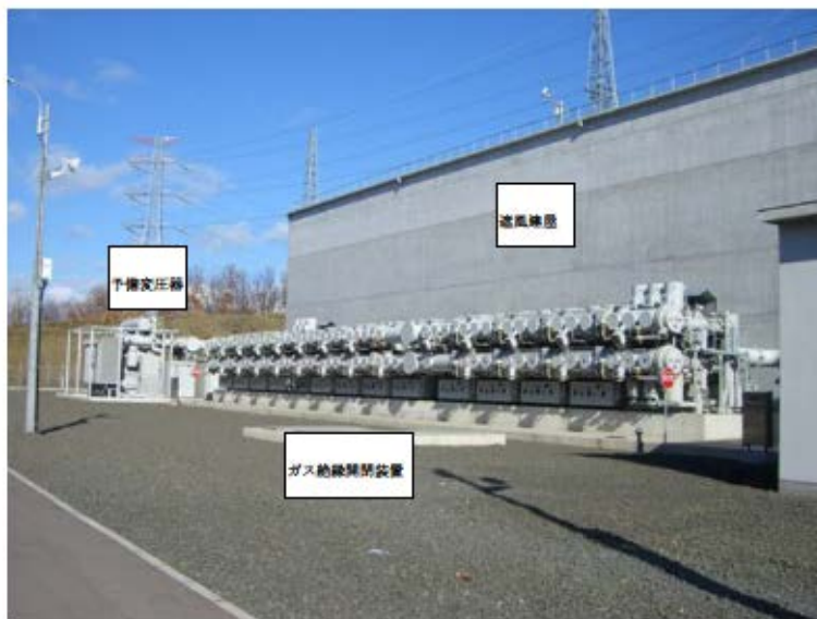
275kV GIS (架線部なし)
