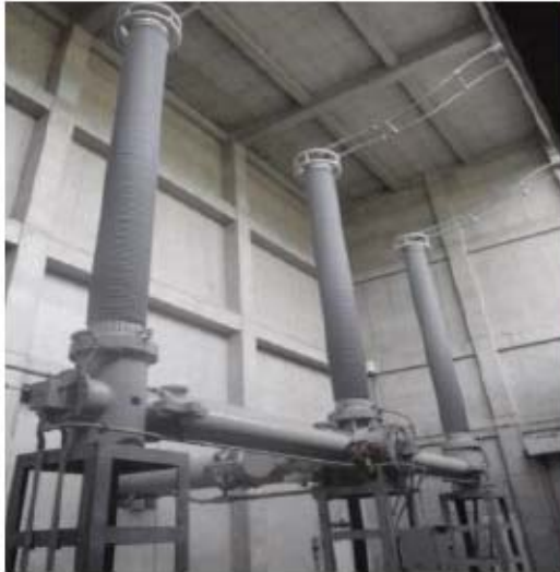
275kV プッシングの外観
