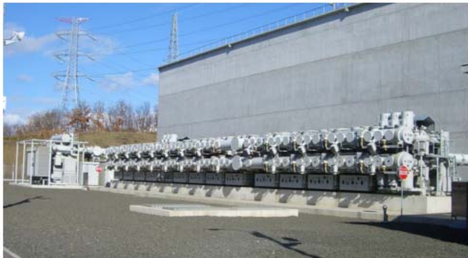
開閉所 275kV ガス絶縁開閉装置
