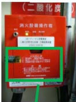
写真⑤ 消火設備操作箱
