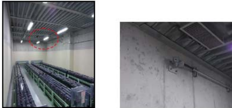
図-2 水素検出器（蓄電池室）
