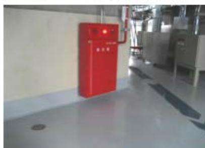
図-9 屋内消火栓
