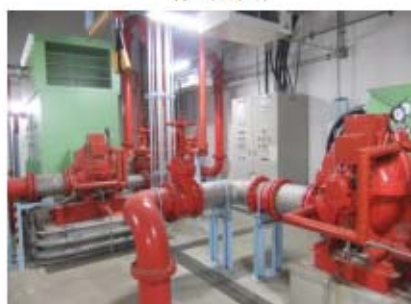
図-12 ディーゼル駆動消火ポンプ（給排水処理建屋内）
