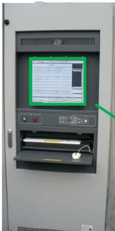
写真④ 中央制御室 総合操作盤
