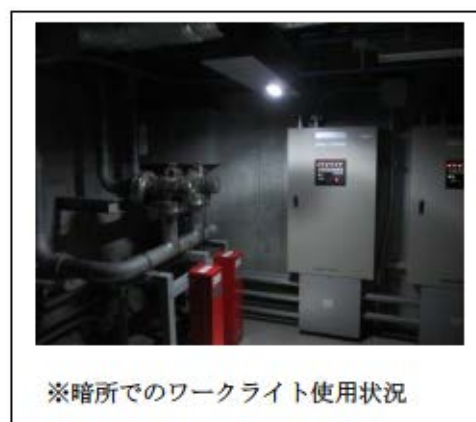
図4 可搬型照明の仕様及び使用状況
