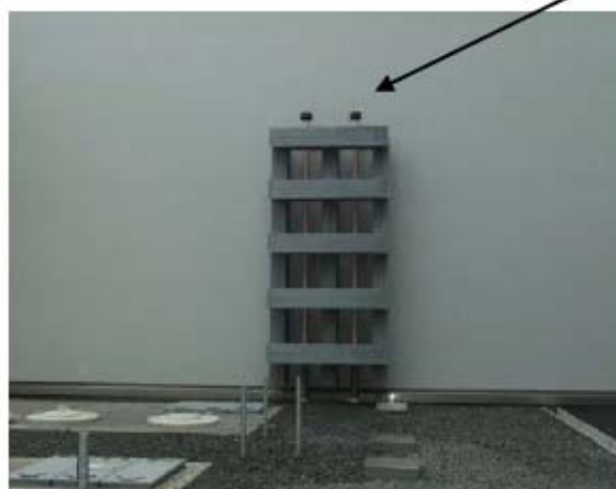
既設燃料油貯油槽ベント管
