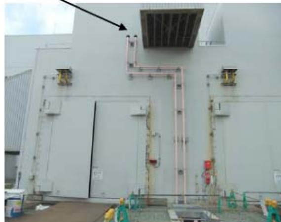
新設燃料油貯油槽ベント管
