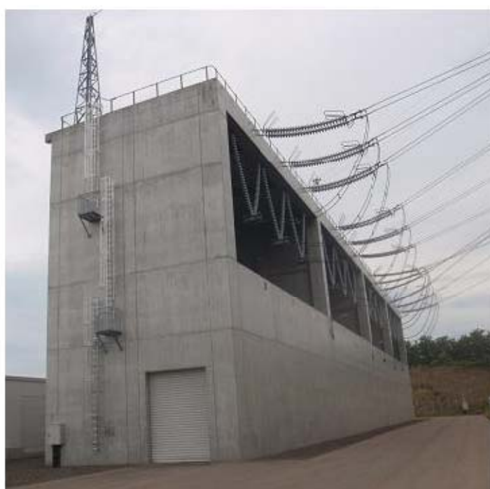
図22-1 開閉所（遮風建屋）
