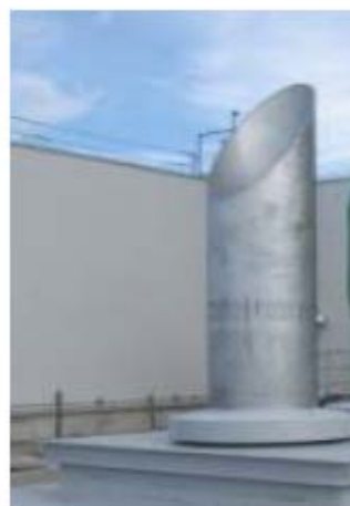
図3 主蒸気安全弁（排気管）の設置状況
