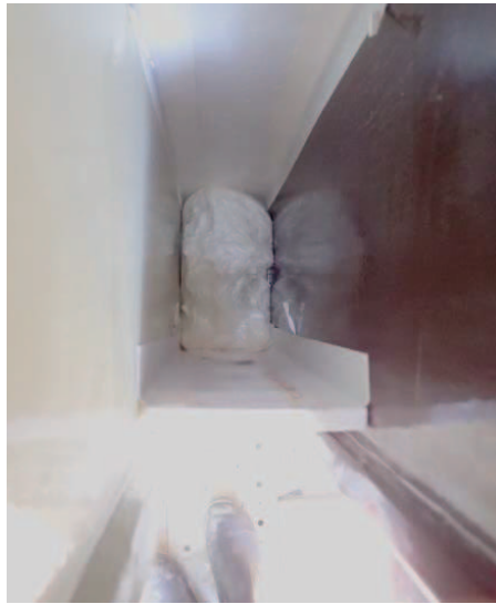
図3 目地内部でのウレタンの発泡状況
