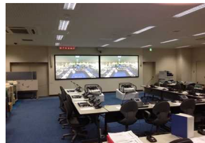
TV会議システム等通信設備
