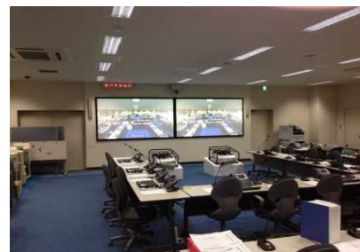
TV会議システム等通信設備
