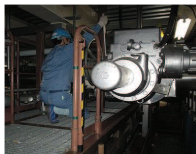
現場手動ハンドルによる開操作
