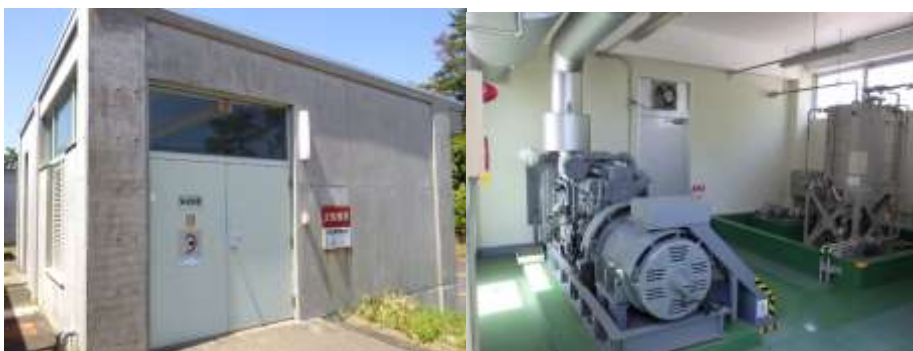
図 2 非常用発電設備の外観写真
