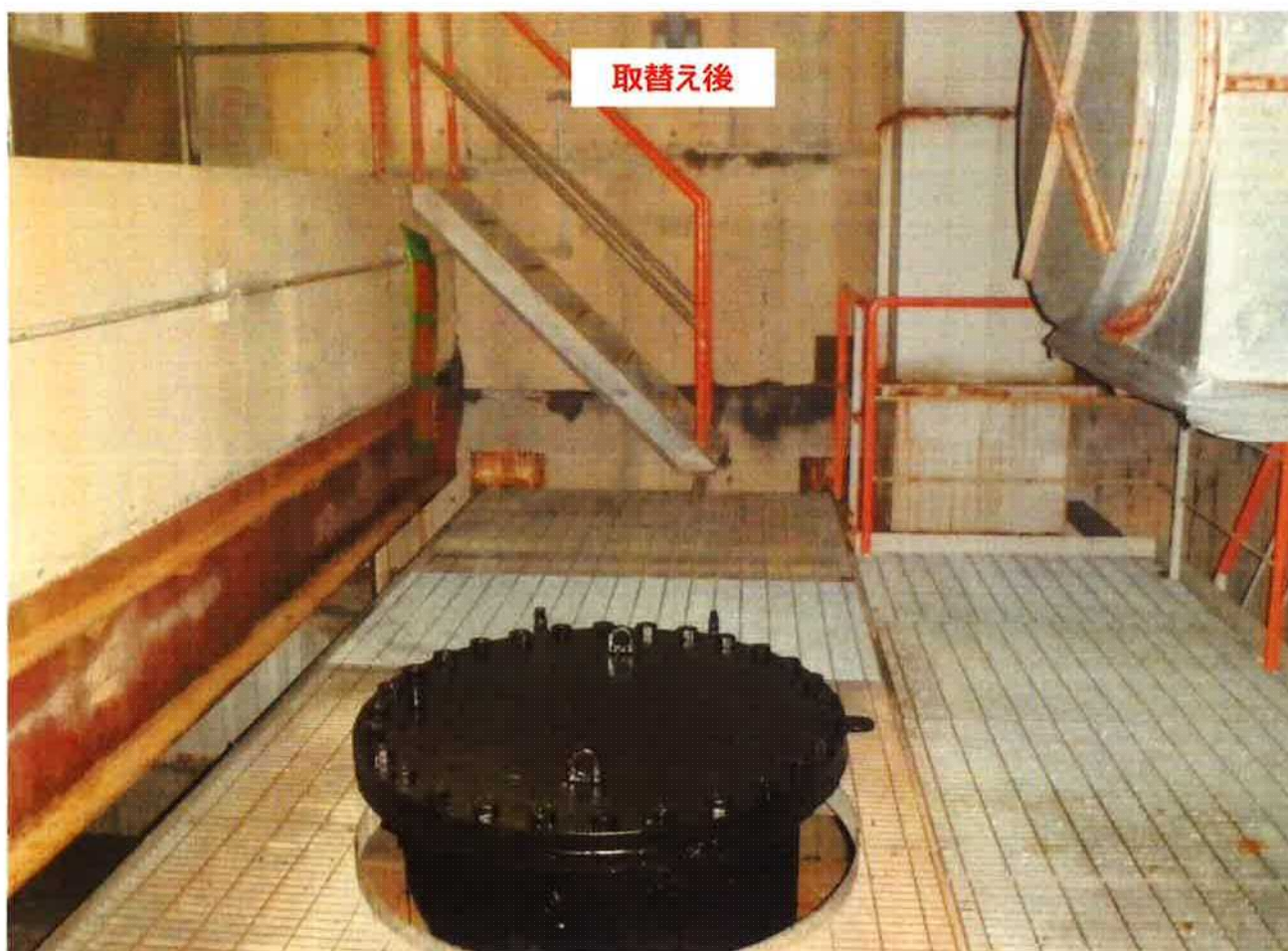
A－循環水系統復旧後、取替え箇所からの漏えいがないことを確認済み
