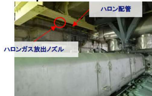
B-非常用ディーゼル発電機室内
