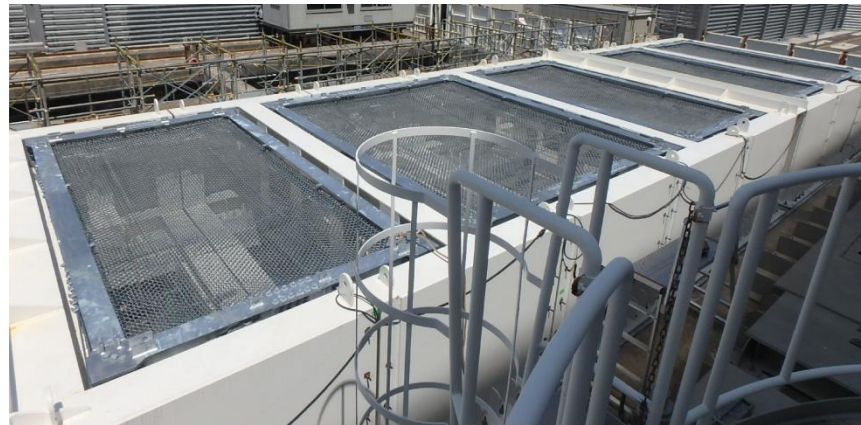
取水槽海水ポンプエリア竜巻防護対策設備
