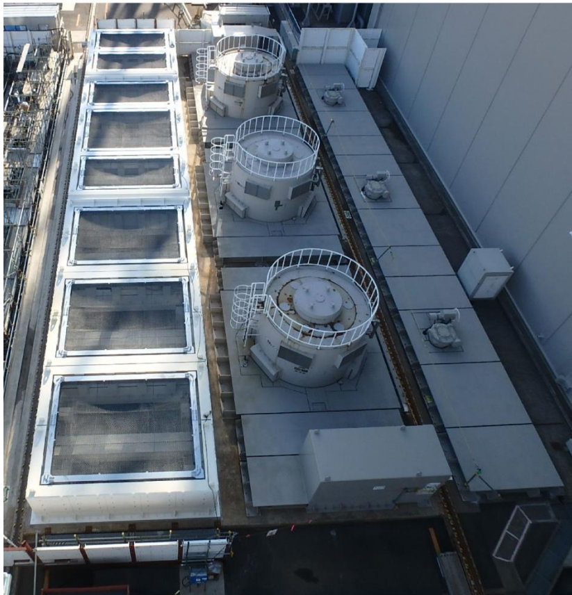
取水槽竜巻防護対策設備
