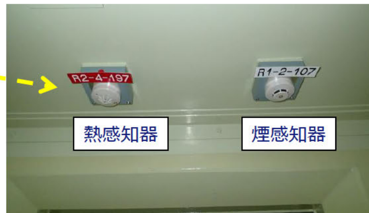
火災感知器の設置状況
