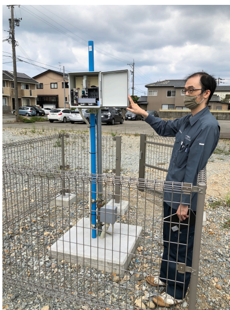
図19 屋外での総合試験用に設置された可搬型モニタリングポスト。
