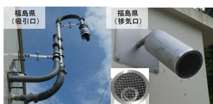
吸引口及び排気口
