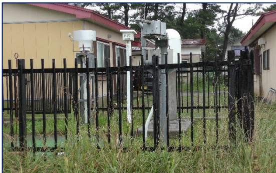
【雑草の生い茂った地面（モニタリングステーション）】
