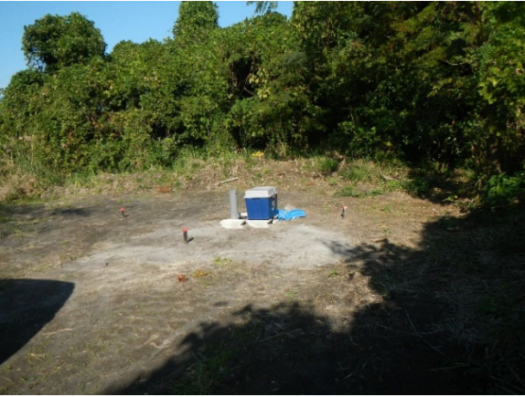
図 1-2-14. 高免アレイ観測点の例 (BK0M6 地点 6)。青色ボックスにロガーおよびバッテリーを収容する。青色ボックスの左側の灰色のパイプが地震計孔口。孔中地震計は地表から 10m の孔底に設置された。
