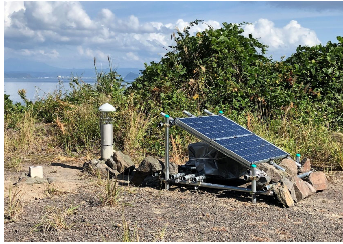
図 2-1-1-6 OSKB 観測点の機器設置状況
