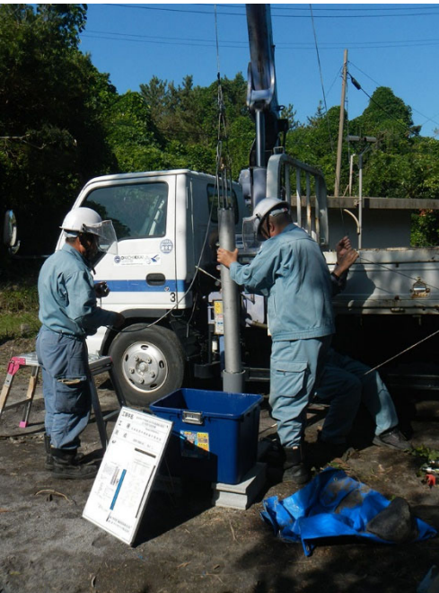
図 1-2-15. 孔中地震計と設置作業。中央の筒状の物体が孔中地震計 (SMN0100-4) 本体である。
