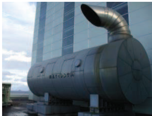
図 1.5-8 非常用ディーゼル発電設備排気消音器
