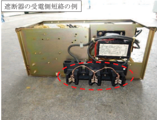
図 4.5.3 遮断器の短絡箇所 (MCC 試験時)
