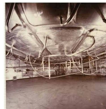
高放射性廃液貯槽 (V35) 下部
