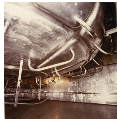
高放射性廃液貯槽(V31) 下部
