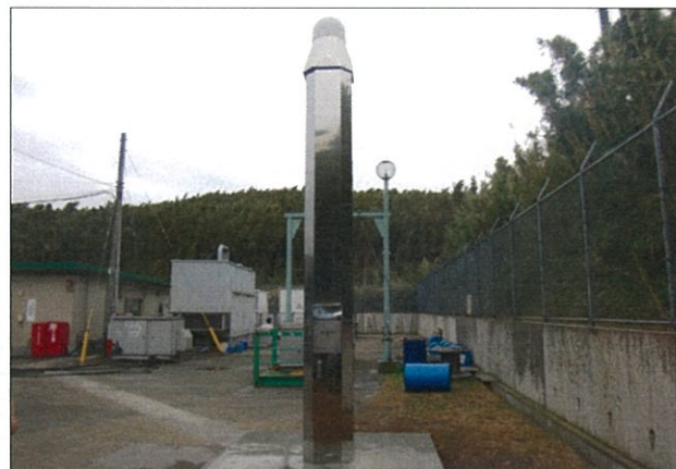
竹島の機器設置状況
