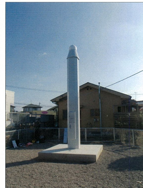
吉野町の機器設置状況
