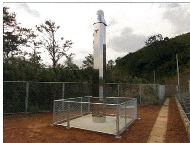
黒島の機器設置状況
