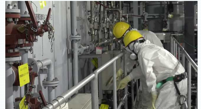
検査官によるALPS巡視の様子
