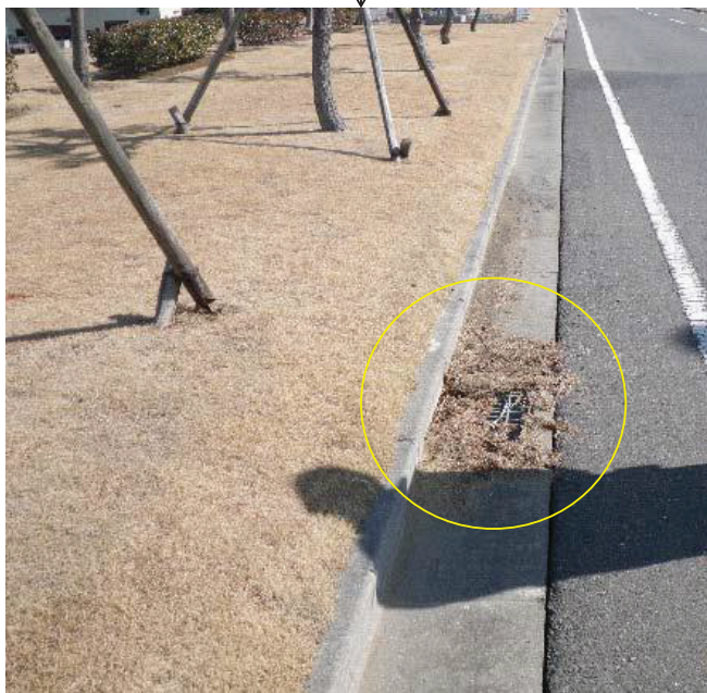
写真2 構内道路上に残留した塵芥
