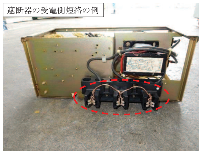
図 4.5.3 遮断器の短絡箇所(MCC 試験時)
