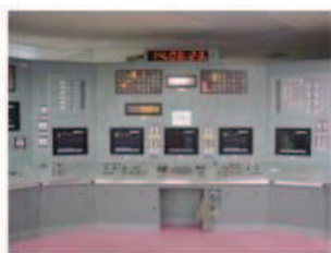
通常点灯時 (非常用照明及び直流照明兼非常用照明)
