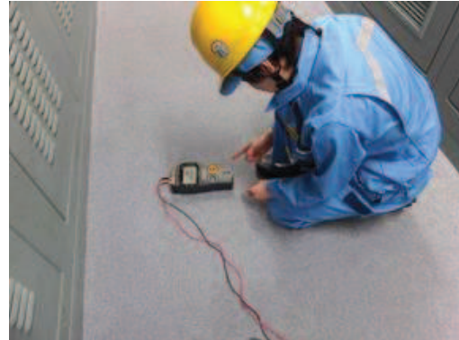
②電池容量確認
