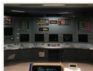
直流照明兼非常用照明点灯時のイメージ (写真：シミュレータ設備)
