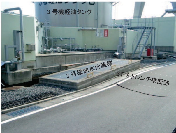
写真① 沈下発生状況
