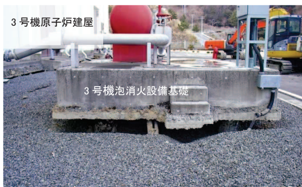
写真⑥ 沈下発生状況
