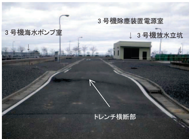
写真㉓ 沈下発生状況
