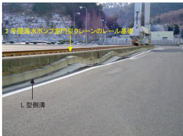
写真㉔ 沈下発生状況
