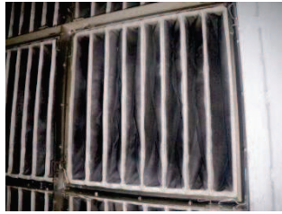
(バグフィルタ入口側)
