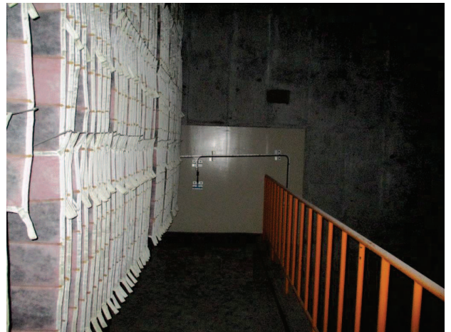
(バグフィルタ出口側)
