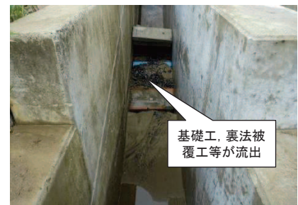
◆ ケース5-1-2m(地盤改良なし)の試験終了後状況
