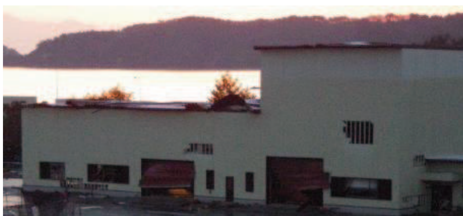
写真 4.2-1(1) 敷地内で確認された東北地方太平洋沖地震に伴う津波の漂流物（建屋壁材の剥がれ状況）
