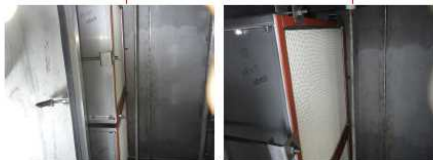
HEPAフィルタ (No.1)
