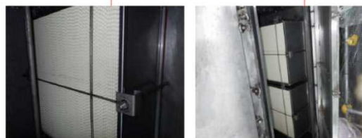
HEPAフィルタ (No.1)
