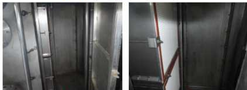
HEPAフィルタ (No.3)
