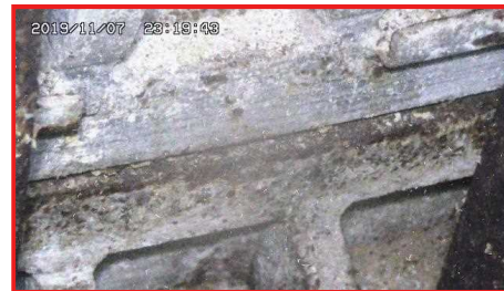
PCVフランジ部
