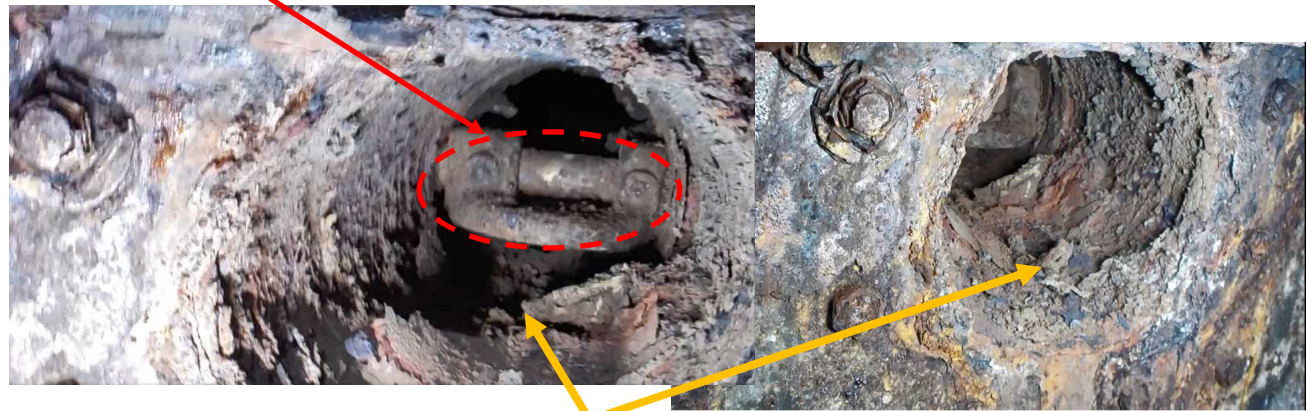
配管内部の状況：堆積物が確認された。
