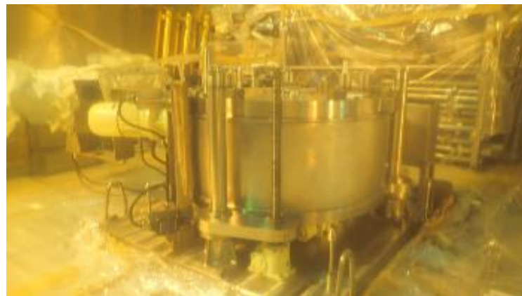
遠隔交換装置全景
