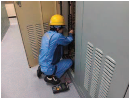
③可搬型計測器接続
