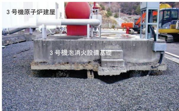
写真⑥ 沈下発生状況
