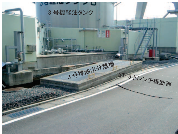
写真① 沈下発生状況
