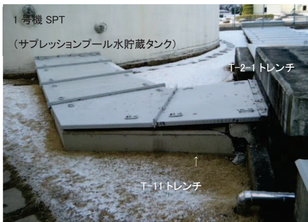
写真㉔ 沈下発生状況
