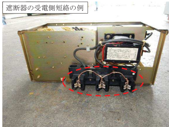
図 4. 5. 3 遮断器の短絡箇所 (MCC 試験時)
