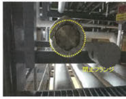
③ 蒸気供給用ホース接続口
