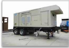
① 移動式発電機(既設同等)
