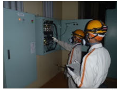
③ 電源切替盤(想定)
