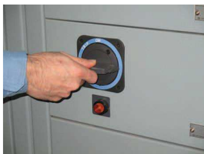
遮断器「切」操作
