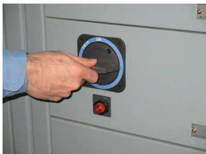
遮断器「切」操作
