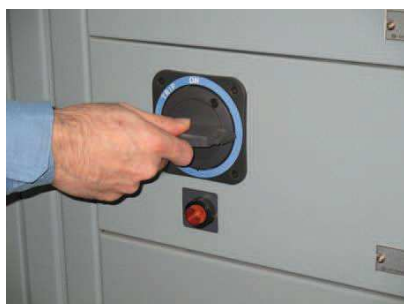
遮断器「切」操作
