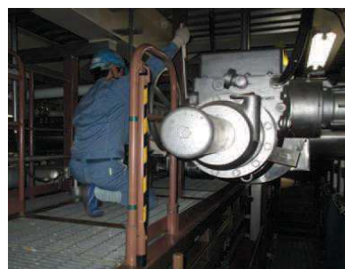
現場手動ハンドルによる開操作
