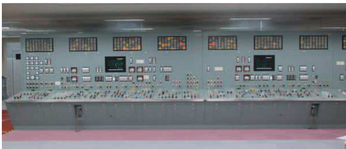
原子炉冷却制御盤
