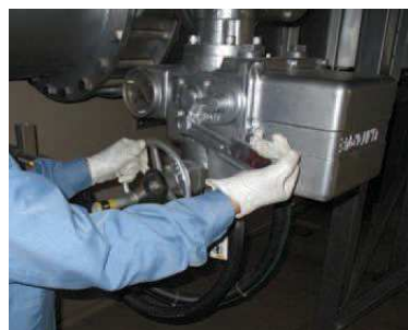
現場手動ハンドルによる開操作
