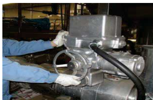
現場による電動弁の手動操作例
