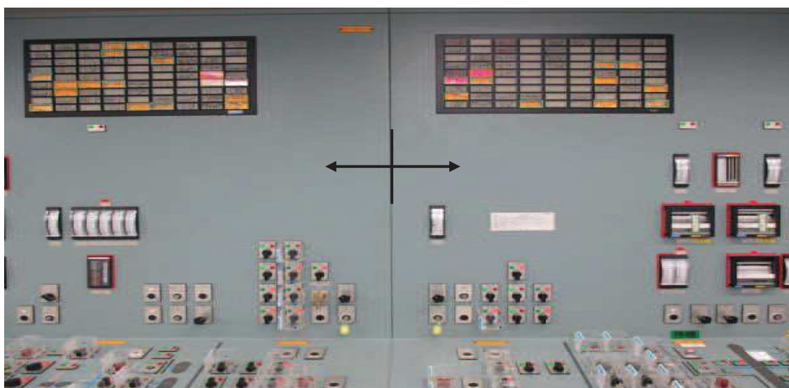
原子炉冷却制御盤 区分 I, II 分離状況
