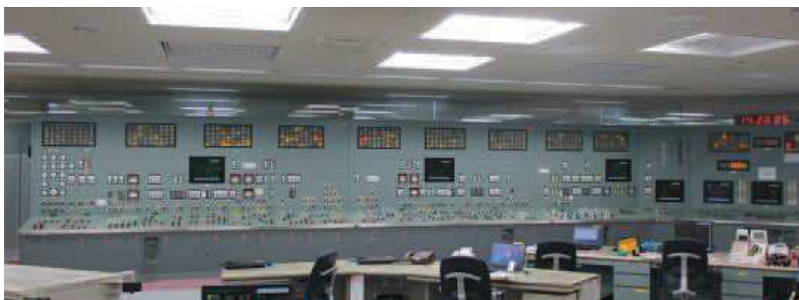
中央制御室主要盤配置
