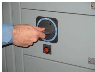
遮断器「切」操作
