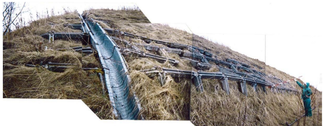
道東地域における凍上による斜面の変状 地盤工学会 (2010) より抜粋
