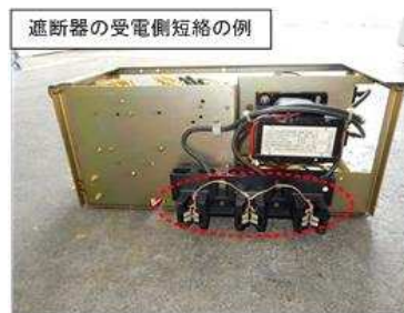
図 4-9 遮断器の短絡箇所 (MCC 試験時)
