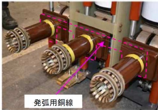
発弧線の設置状況(遮断器2次側端子)
