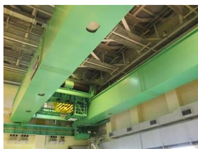
原子炉建屋クレーン
