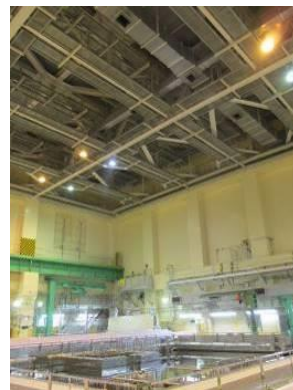
使用済燃料貯蔵プール 上部天井
