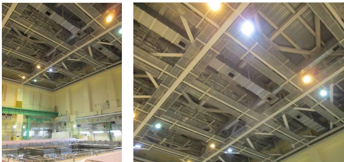
図7-11 使用済燃料貯蔵プール上部のダクト 設置状況
