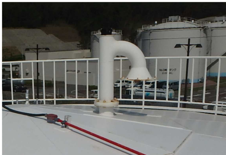
図6-3 軽油タンクの通気口
