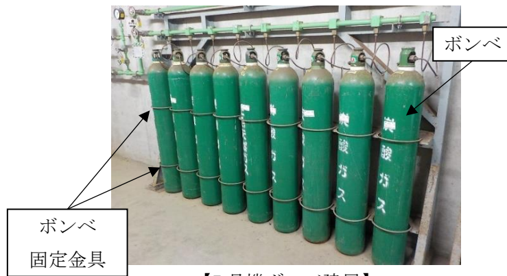
【7号機ポンベ建屋】 二酸化炭素ポンベ
