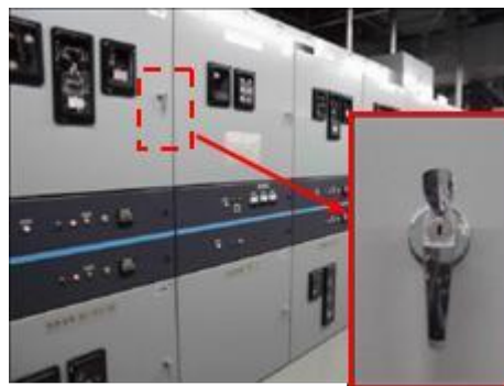
電源盤の施錠
