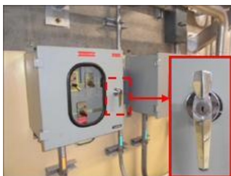
制御盤の施錠
