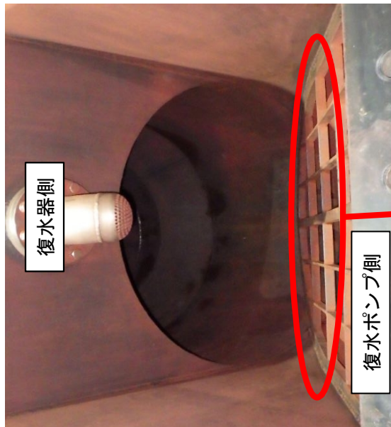
3B-復水ポンプ入口ストレーナ
