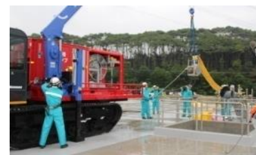
取水ポンプ車操作訓練
