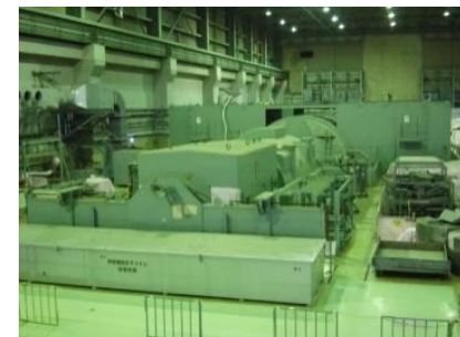
タービン・発電機
