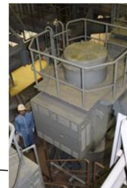
復水ポンプ（2号機の例）
