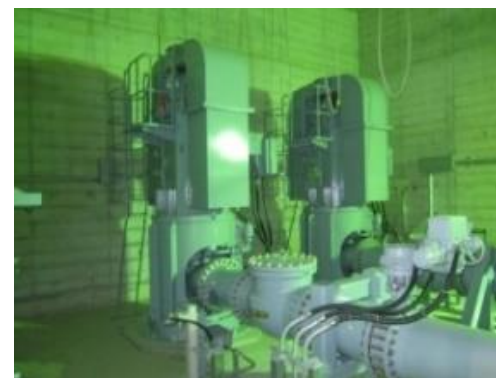
EWSポンプ（4号機）
