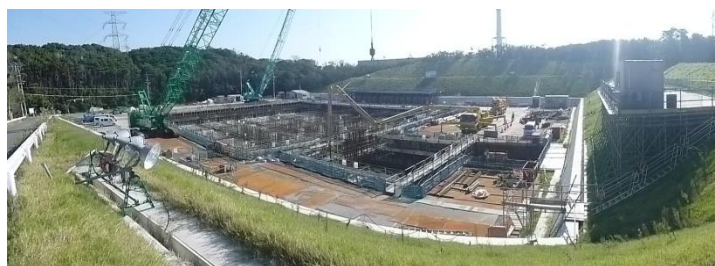
緊急時淡水貯槽
