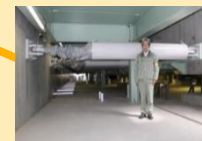
【地下免震装置】
