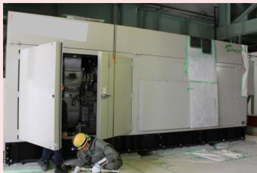
【緊急時ガスタービン発電機】
