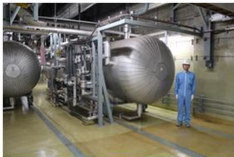
給水加熱器 （2号機の例）
