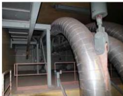
主蒸気配管（2号機の例）
