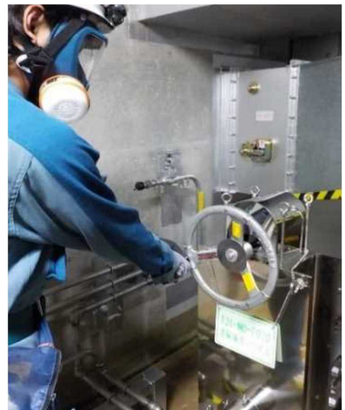
格納容器ベント操作
