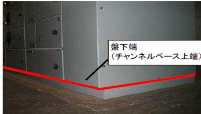
第 1.1-4 図 機能喪失高さ（盤の例）
