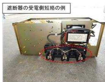
図 4-9 遮断器の短絡箇所 (MCC 試験時)
