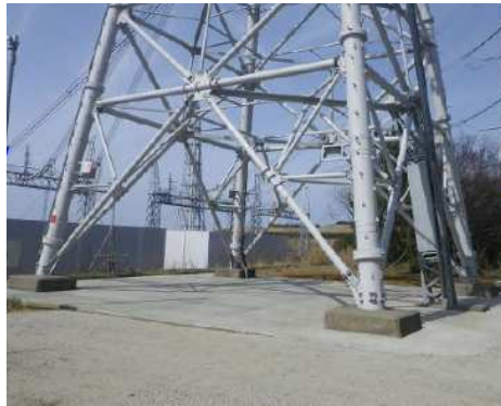
(500kV 新新潟幹線 No. 1 送電鉄塔)
