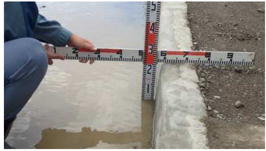
復旧前の段差状況
