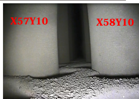
第五管支持板上
