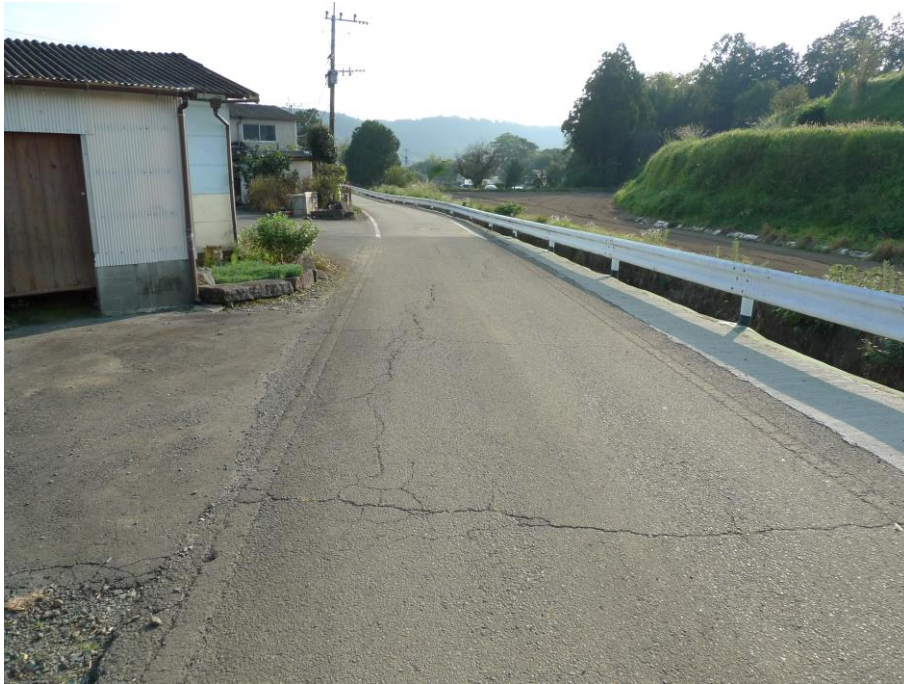
図 2-15 陣内トレンチ周辺状況 Loc.5 (道路上に雁行亀裂)
