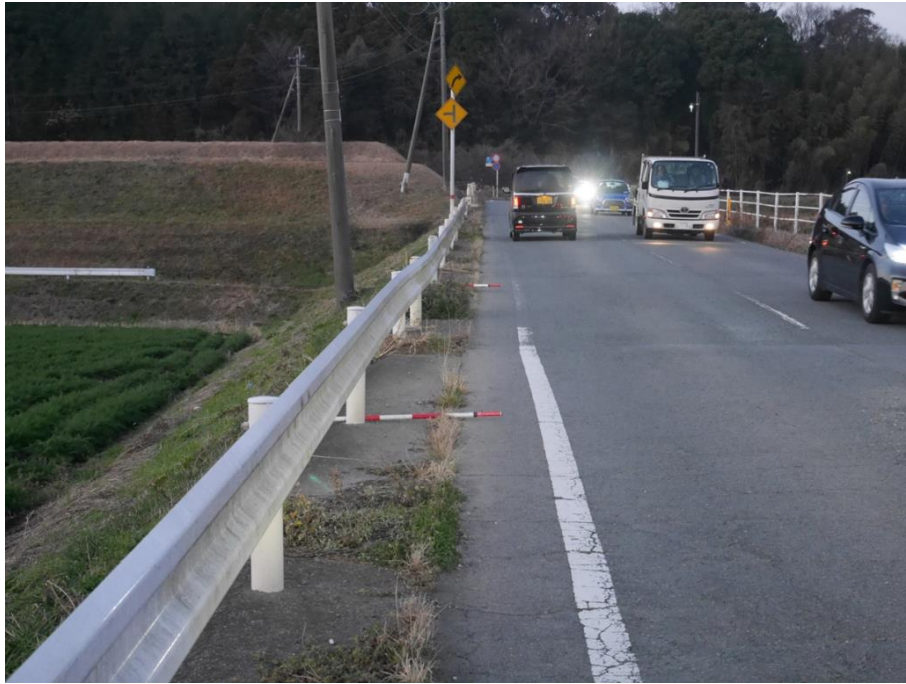
図 2-11 陣内トレンチ周辺の状況 Loc.1 (右横ずれ約 15cm)
