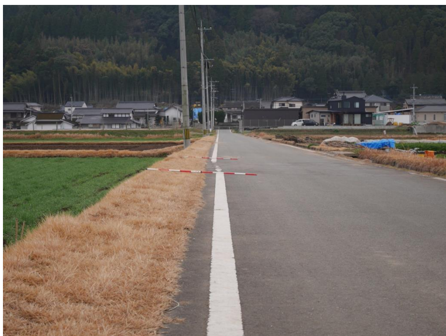
図 2-14 陣内トレンチ周辺の状況 Loc.4 (右横ずれ約 20cm)
