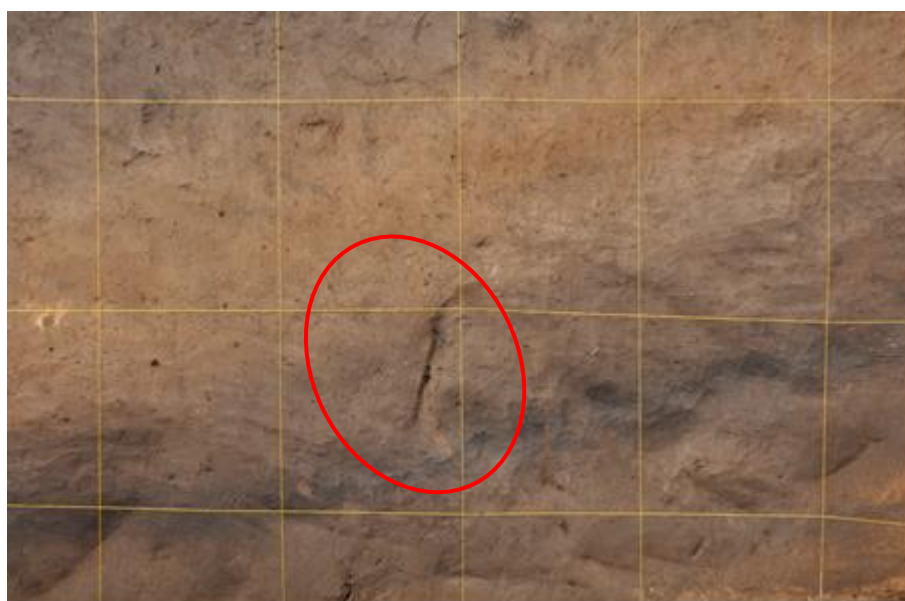
図 2-34 開口亀裂に切断される密着したせん断面
