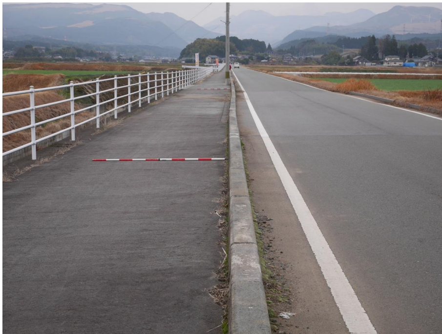
図 2-13 陣内トレンチ周辺の状況 Loc.3 (右横ずれ約 20cm)
