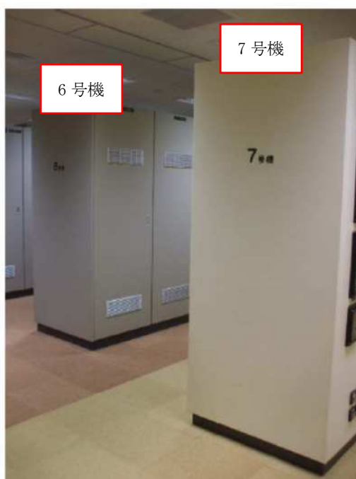
図2-26 制御盤（裏盤）の色別管理
