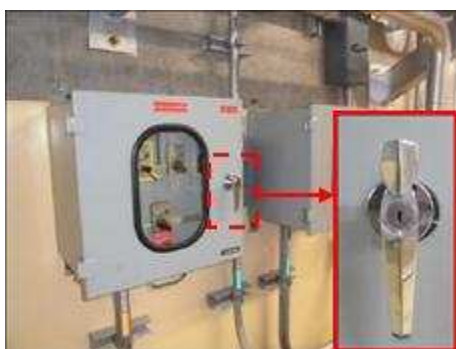
制御盤の施錠
