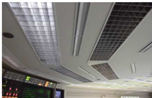
図 1-3 中央制御室照明
