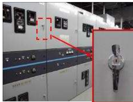
電源盤の施錠
