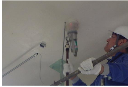
図 6.5-6 自動火災報知器動作確認（天井）
