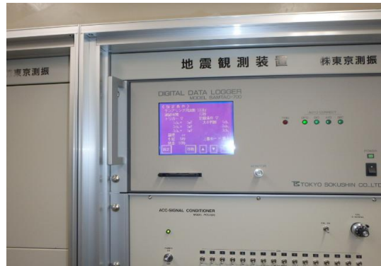
図 6.5-8 地震計動作確認
