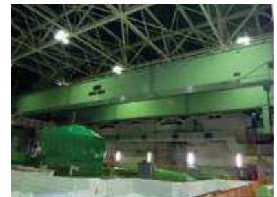
⑦原子炉建屋クレーン
